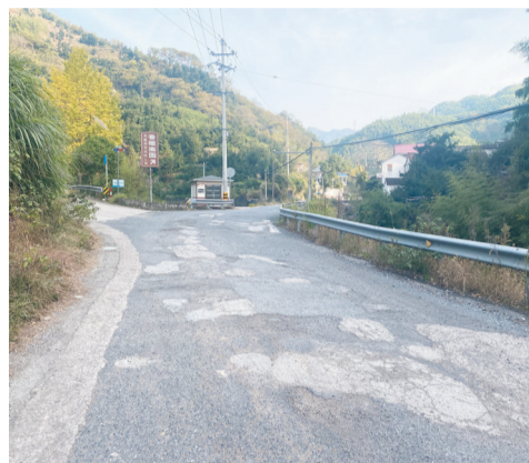
斯宅至里四道路破损严重。
