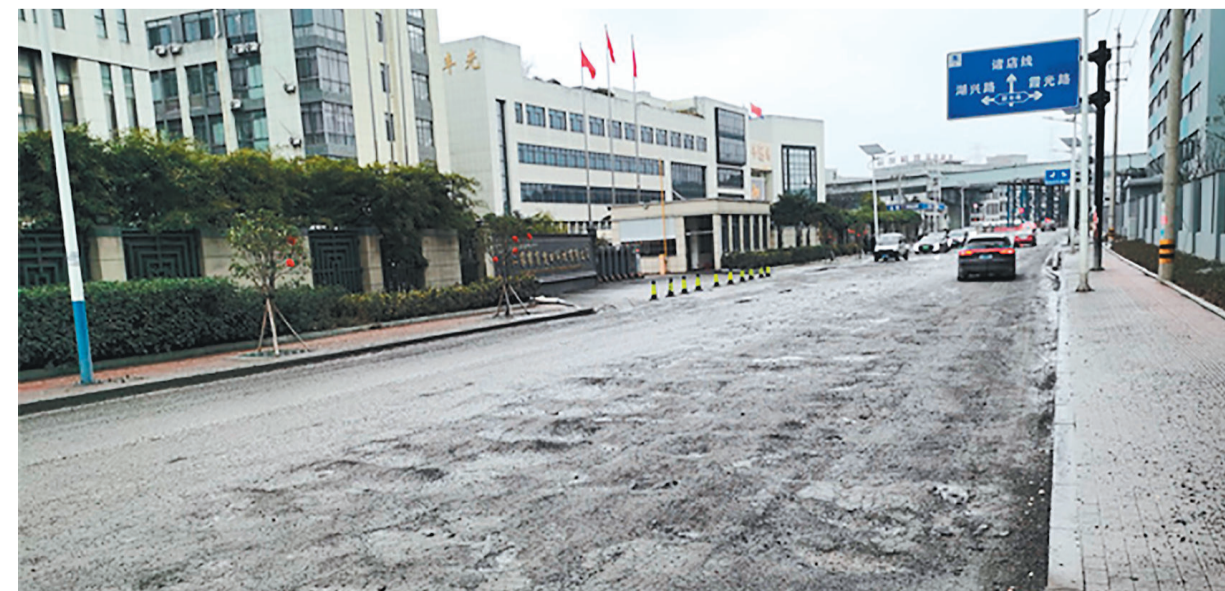
店口丰江路道路破损。
