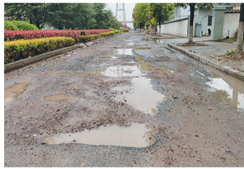
大侣路北侧道路坑洼。
